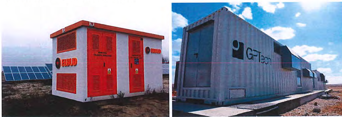
Rysunek 27. Stacja transformatorowa
