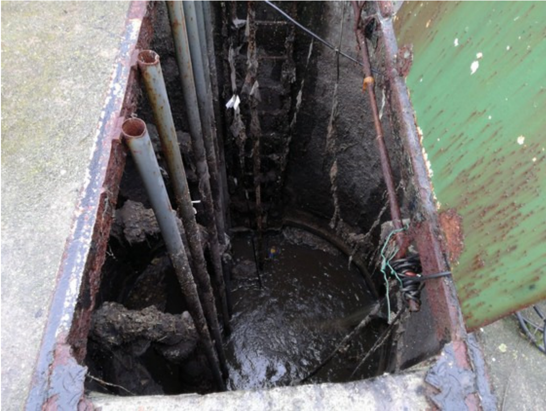
Zdjęcie 1, 2. Widok pompowni głównej
