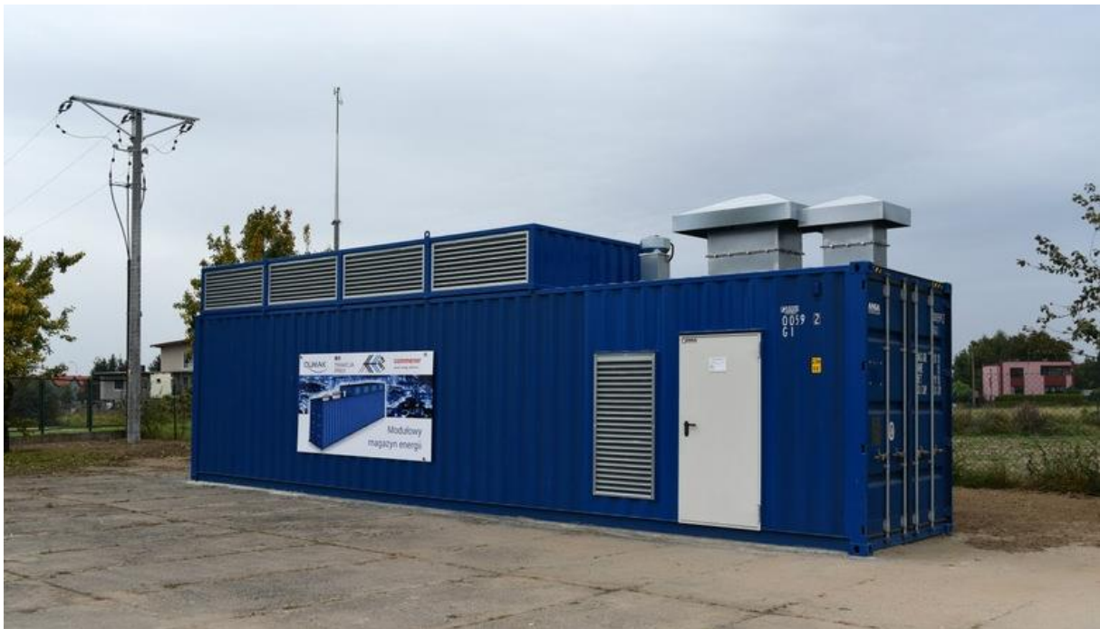
Rysunek 15 Modułowy (kontenerowy) magazyn energii, który będzie zastosowany w planowanych elektrowniach Nowe Miasteczko 1, Nowe Miasteczko 2.
