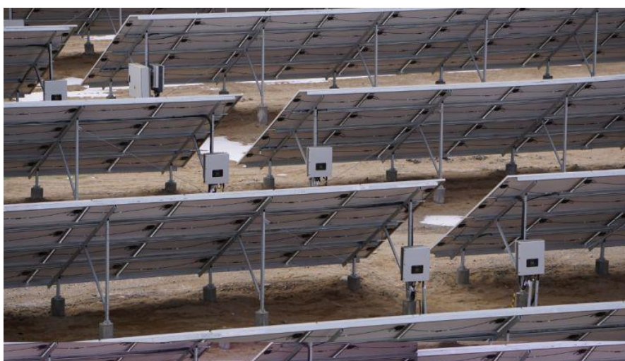
Fot. 16. Mikroinwertery na przykładowej farmie fotowoltaicznej
