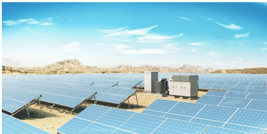
Fot. 15. Inwerter centralny na przykładowej farmie fotowoltaicznej
